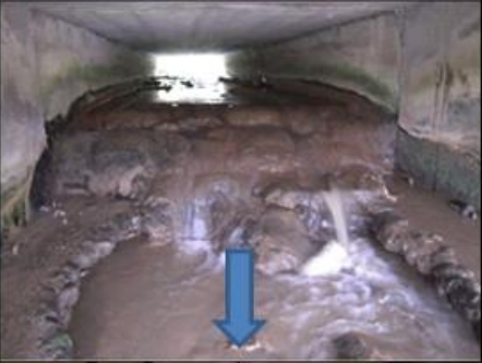
Passage sous la D 905 colmaté par le tuf vu depuis l'aval.
