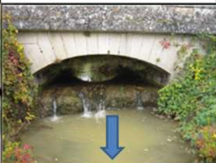
Passage sous l'ancien tracé de la D 905 colmaté par le tuf vu depuis l'aval.
