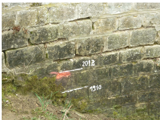
Photo 20 : repère de crue à la Loges-Pomblin (10)
